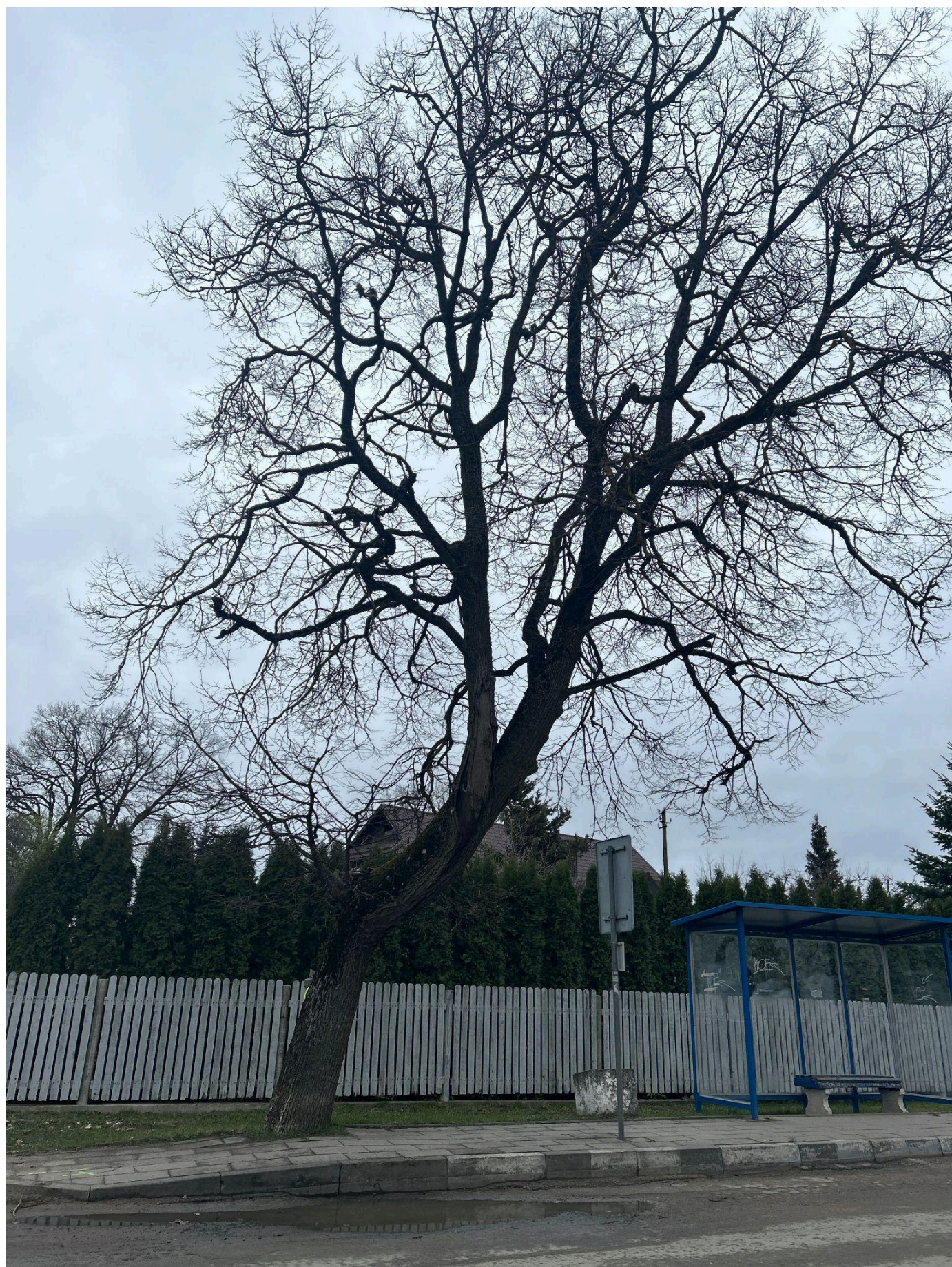
Mažalapé liepa (nr. 25 plane) - siūloma šalinti. Stiprus kamieno pasvirimas link važiuojamosios dalies. Laja ir skeletinės šakos stipriai apgadintos sunkiasvorio transporto.
