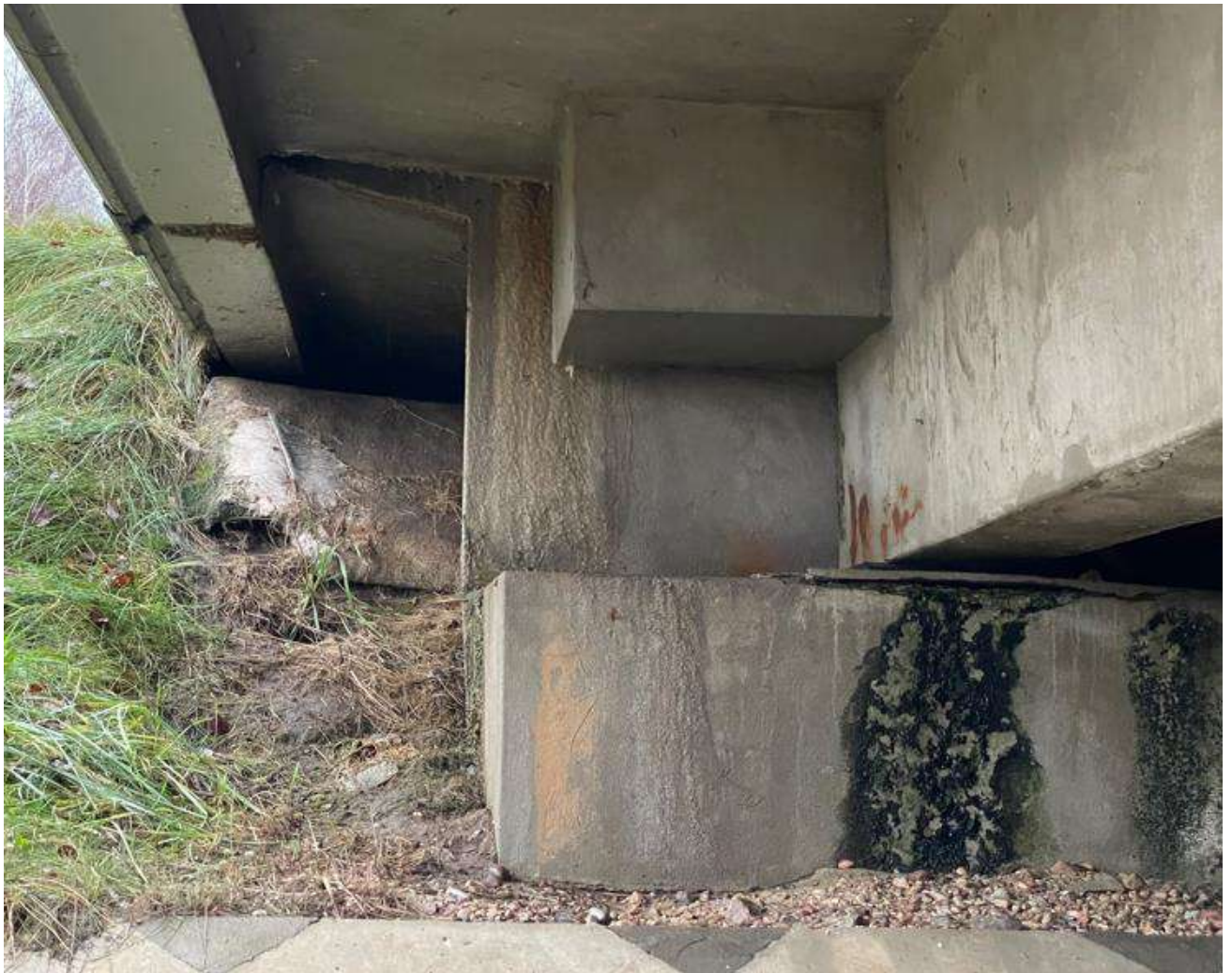
13 pav. Krantinėse atramose vietomis atšokęs betono apsauginis sluoksnis, dėl nesandarių deformacinių pjūvių perdanga nuolat drėkinama
