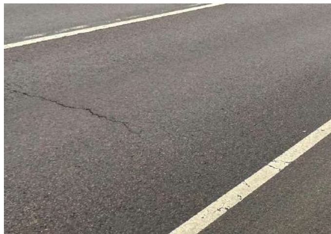
8 pav. Asfalto danga įtrūkusi
